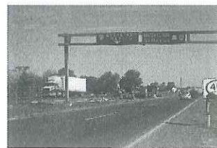
Km 22+100. Vista hacia Ciudad B. Actividades de implementación de desvío de tránsito encuerdo A.
